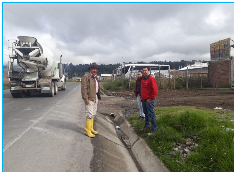
Ilustración 24. Estado de las cunetas de la Panamericana Sur.
