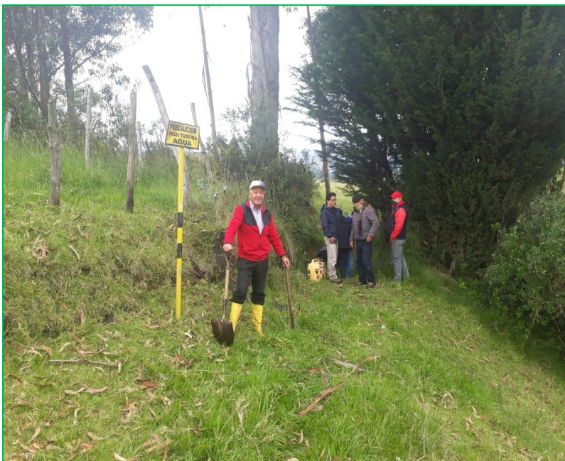
Ilustración 52. Trabajos de control de aforo de agua potable, del que se benefician Calpi urbano y Bayushi.
