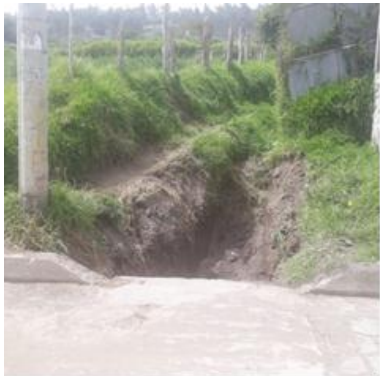
Ilustración 78: Excavación peligrosa en la alcantarilla-acceso al desfogue natural Pampa de gobierno.
