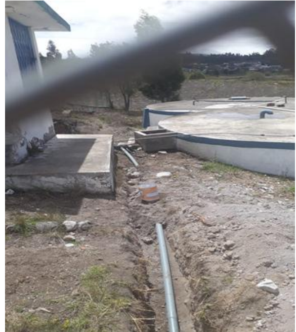
Ilustración 86: Captación de agua para consumo humano sin autorización.
