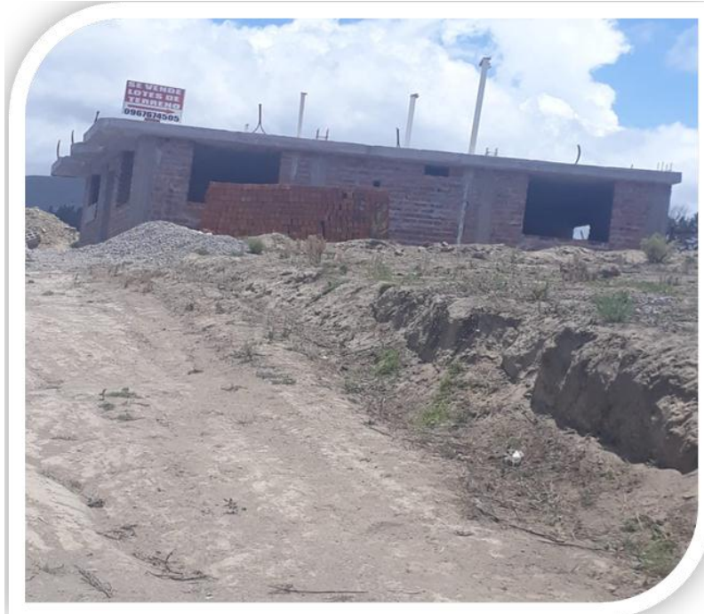
Ilustración 56. Construcción sin autorización-línea de fábrica.
